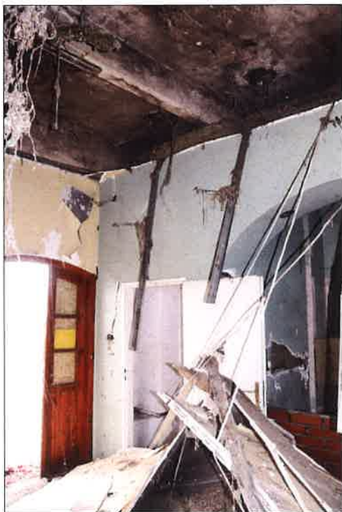
Wnętrze budynku w przyziemiu, widoczne wejście po stronie południowo-wschodniej. (fot. Jakub Andrzejewski, 2021 r.)
