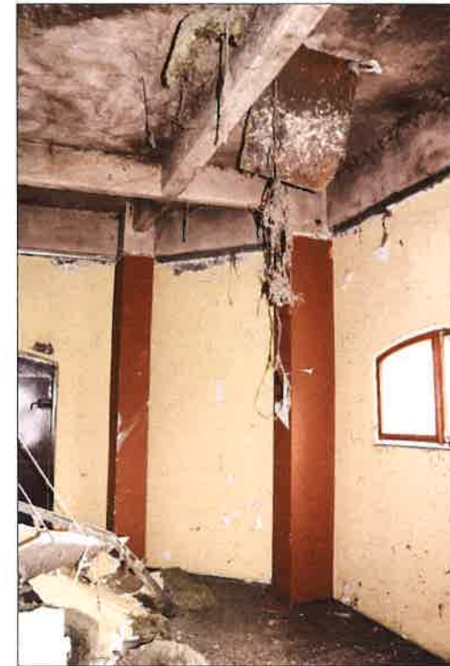
Widok żelbetowego stropu, odsłoniętego po zarwaniu się wtórnego sufitu z płyt karton-gips. (fot. Jakub Andrzejewski, 2021 r.)
