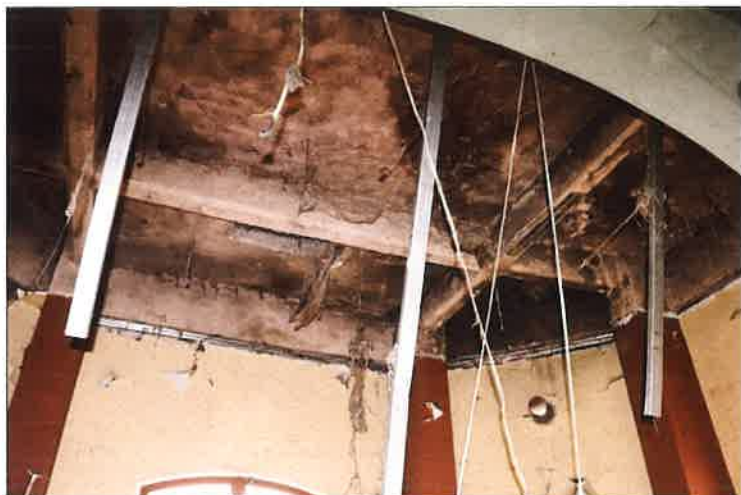
Strop żelbetowy powyżej kondygnacji przyziemia z widocznymi zawilgoczeniami i odspojeniami. (fot. Jakub Andrzejewski, 2021 r.)
